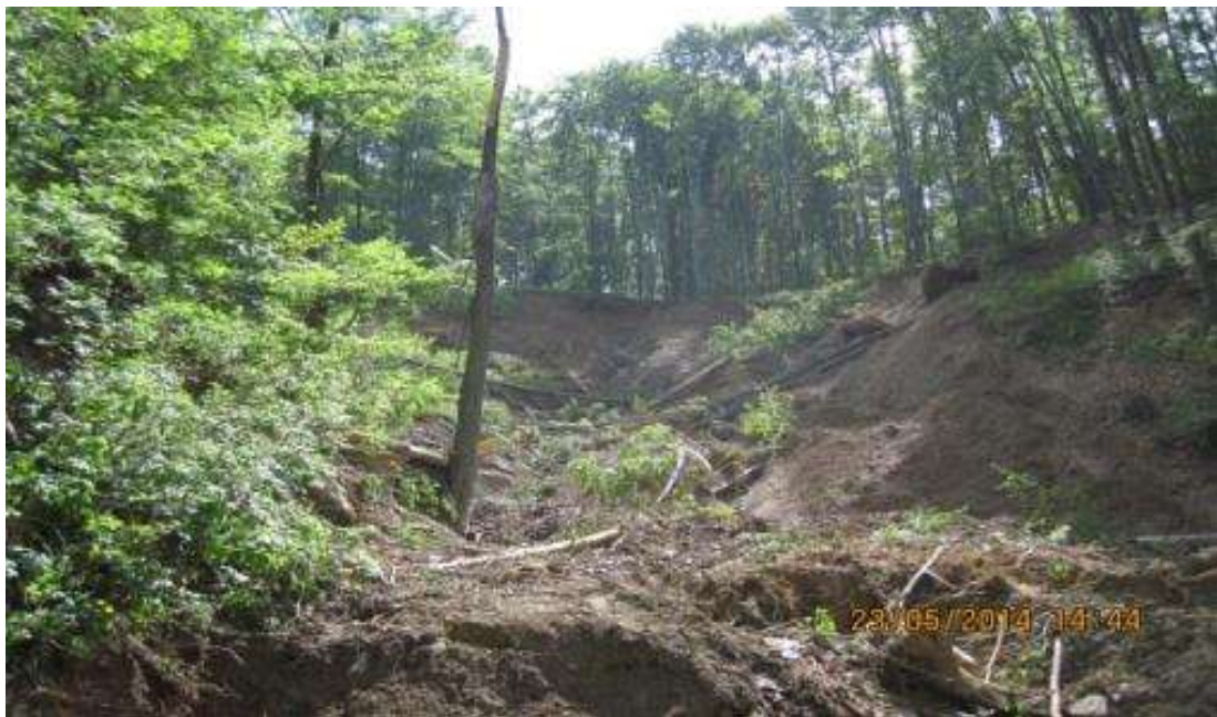
Слика 4. Клизиште на државном путу IIA-139, деоница: Костајник – Столице, км:10+950 -11+070. Figure 4. Landslide on public road no. IIA-139, section: Kosmajnik – Stolice, km: 10+950 – 11+070
