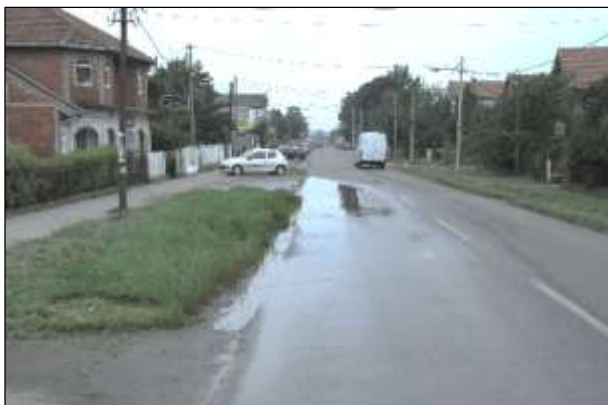
Слика 5. – Задржавање воде на коловозу
