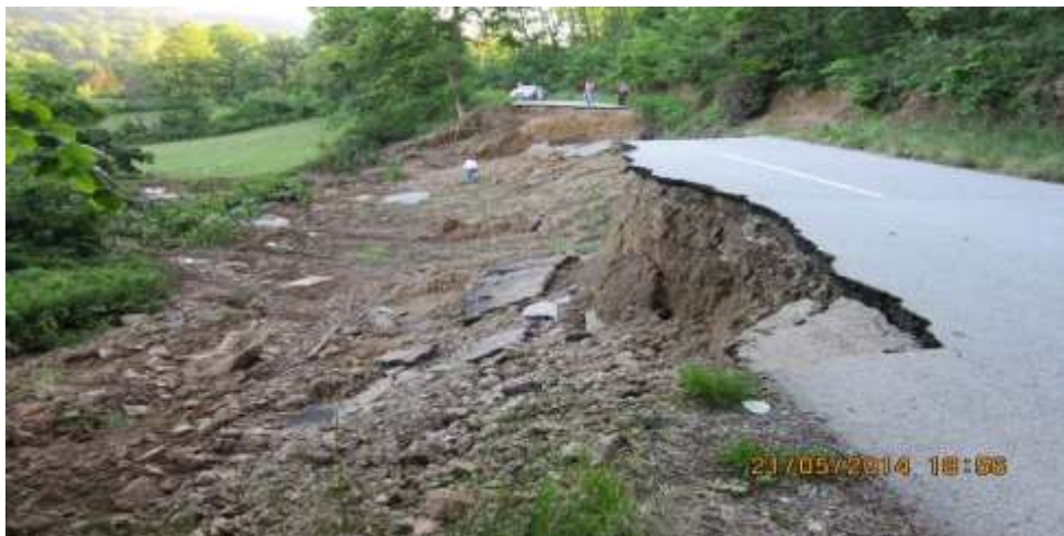
Слика 7. Клизаште на путу IIA-150, km: 82+900, деоница: Босута - Белановица, дужине по путу 75m а низ падину око 60m, Figure 7. Landslide on road IIA-150, km: 82+900, section: Bosuta – Belanovica, length of 75 m throughout the road alignment and 60 m down the slope
