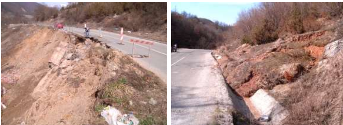
Slike 5. i 6. klizišta na putu IIA 203 Novi Pazar - Tutin
