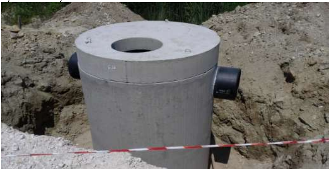
Slika 21. Betonski separator- Koridor 10 autoput E 75
