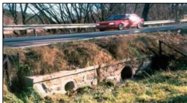
Slika 5. Vodeni propust i mala cev iznad normalnog nivoa vode sa propustom u Češkoj
