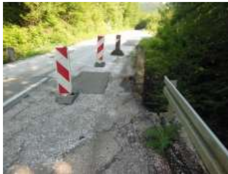
Slika 8. Oštećenje propusta na putu IIA 203 Izvor: Arhiva AD "Novi Pazar – put"
