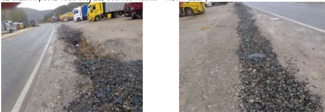
Slika 16.17. Zatrpavanje odvodnog kanala na IB 22, deonica Raška - Novi Pazar Izvor: Arhiva AD "Novi Pazar – put"
