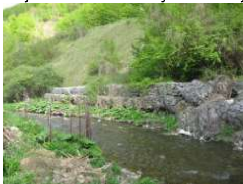
Slika 14. Porušena obaloutvrda u nožici nasipa na km:9+250-9+295 Source: Geotehnički elborat, IIA 203, Institut za puteve, Beograd
