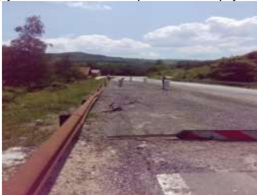
Slika 15. Oštećenje na IB 22, deonica Novi Pazar – Ribarići, na km:276+800 Izvor: Arhiva AD "Novi Pazar – put"
