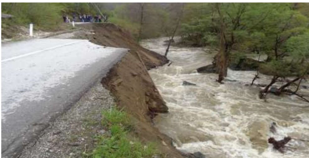
Слика 8. Клизаште на државном путу IB-30, деоница: Ивањица-Ушће, km:38+100 Figure 8. Landslide on public road IB-30, section: Ivanjica-Usce, km: 38+100
