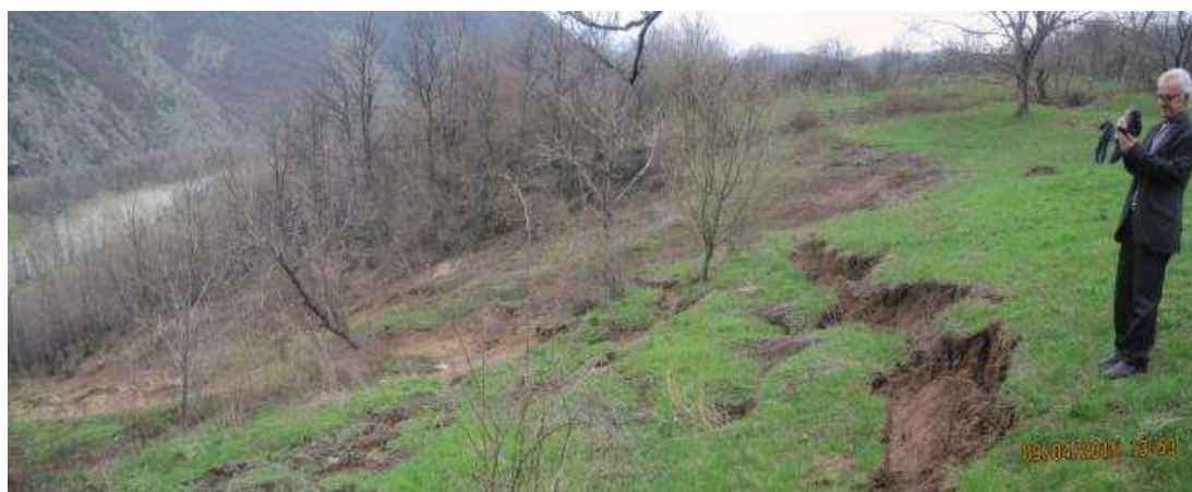
Слика 9. Клизаште на државном путу IB-22, деоница: Краљево – Ушће у месту Пивнице, km:390+050, величине око 350-400m x 200-250m x око 5-8m. Figure 9. Landslide on public road IB-22, section: Kraljevo – Usce in Pivnice, km: 390+050, size of the event 350-400m x 200-250m x 5-8m
