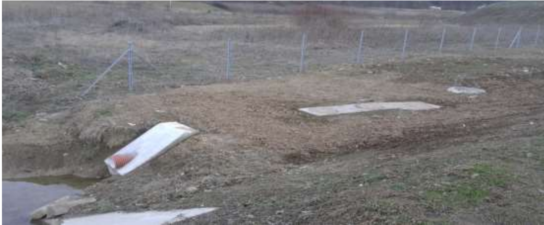
Slika 24 Ugrađen plastični separator sa izlivom u otvoreni kanal Koridor 11 autoput E 763
