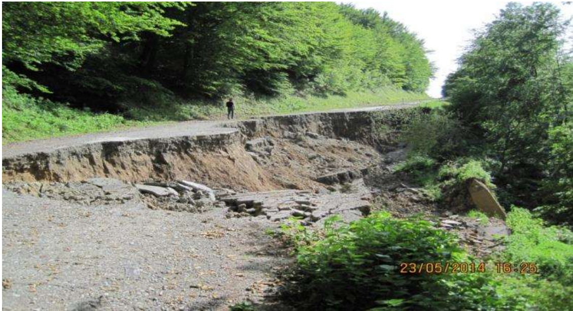
Слика 3. Клизиште на државном путу IIA-137 Крупањ - Мачков Камен - Грачаница, км:6+900. Клижењем је потпуно уништен труп пута у дужини од 60м Figure 3. Landslide on public road no. IIA-137 section Krupaњ – Mачkov Kamen – Gracanica, km 6+900. Totally destroyed roadbed bz sliding at the length of 60m.
