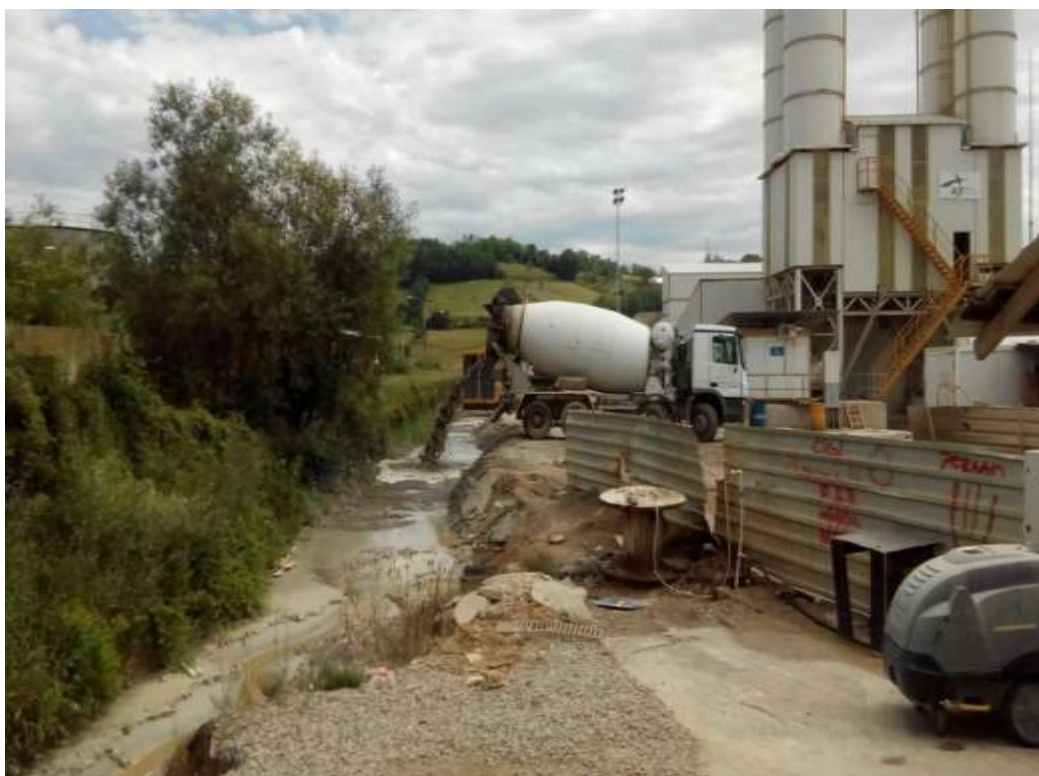
Slika 2. Ispiranje miksera za beton u kanal neposredno pre ulivanja u reku. (Izvor, autor teksta)
