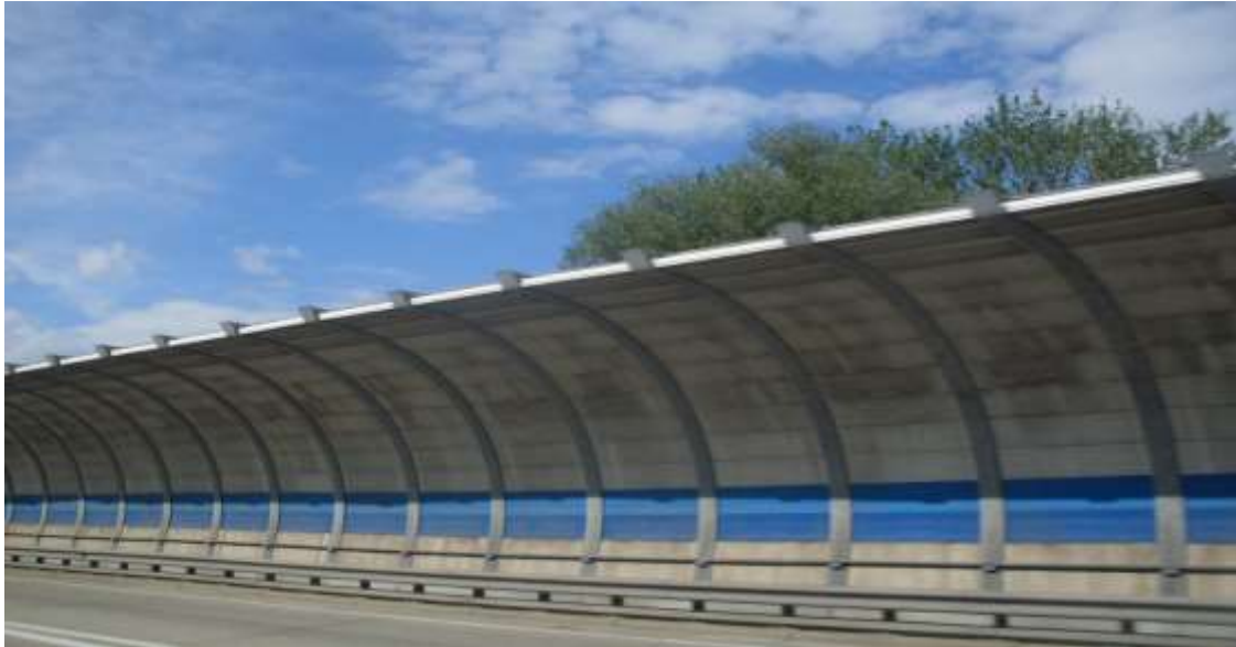
Slika 8. Izgled lucnog zida za zaštitu od buke (Autor rada)
