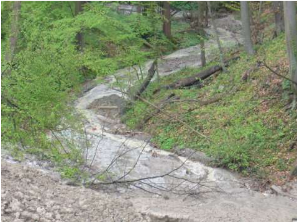
Slika 6. Ispiranje miksera za beton u jarugu u neposrednoj blizini značajnog objekta na trasi autoputa. (Izvor, autor teksta)
