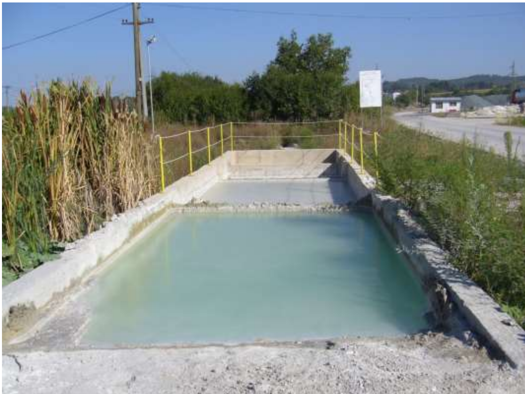
Slika 11. Još jedan primer dobre građevinske prakse u zaštiti životne sredine - Bazen sa taložnikom za pranje miksera za beton na gradilišnoj bazi.
