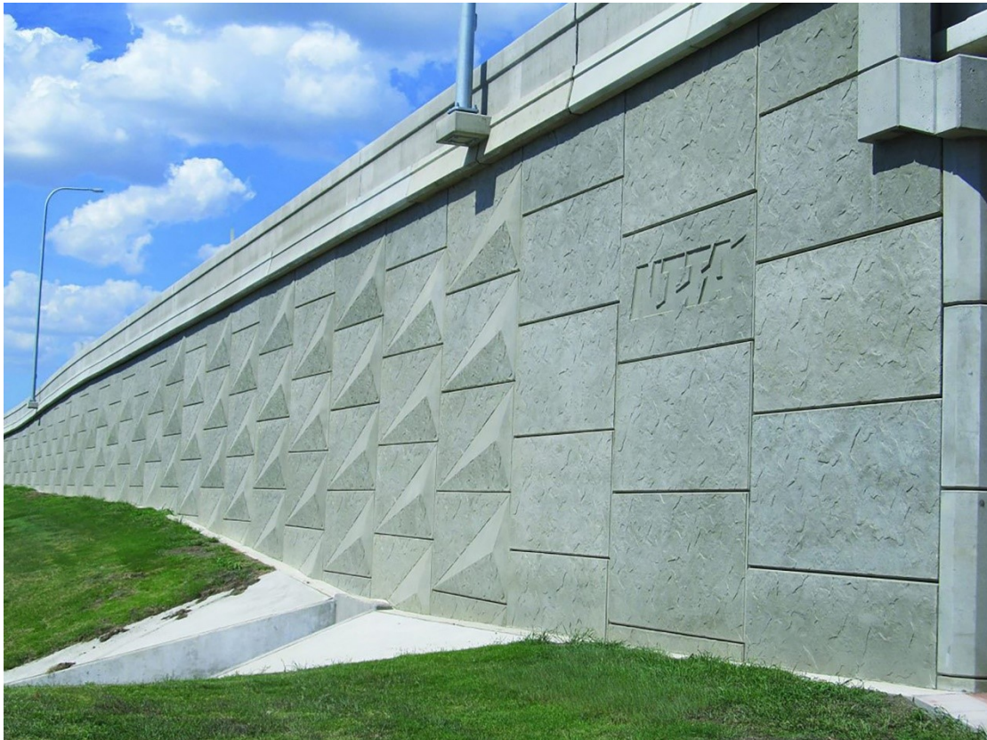
Slika 11. Potporni zid od armirane zemlje sa licem od prefabrikovanih betonskih elemenata (Izvor: L.9)
