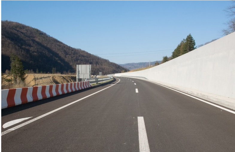
Slika 11. Neadekvatno uklapanje potpornog zida u postojeći teren [7]
