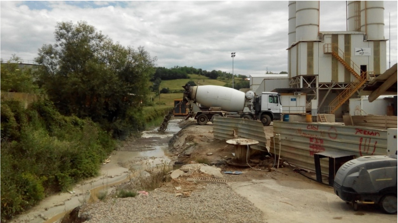
Слика 1 - Испирање миксера за бетон у канал непосредно пре уливања у реку Лесковицу.
